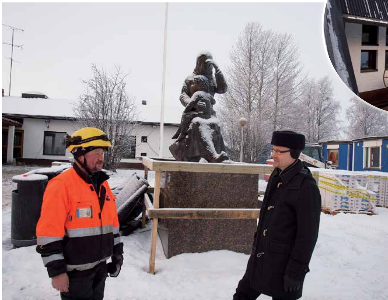
Työnjohtaja Reijo Nurmikumpu (vas.) ja kirkkoherra Antti Kettunen uskovat, että aikataulussa pysytään seurakuntatalon peruskorjauksen edetessä talven aikana.
